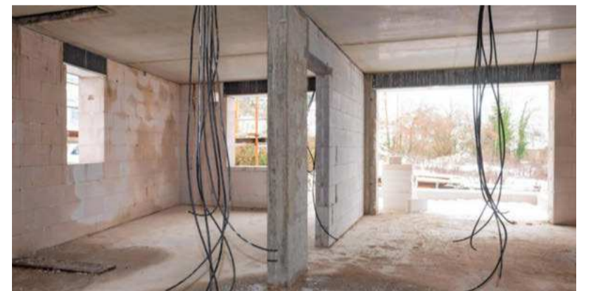
Noch ist der Wohnkomplex ein Rohbau. Sobald es die Witterung zulässt, werden regionale Handwerker den Estrich verlegen und die Fenster einbauen. Fotos: Mario Berger
